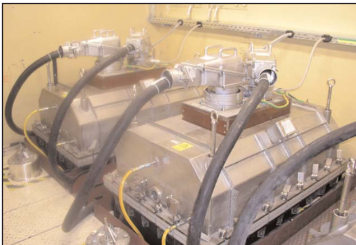
Co-izotóp eltávolító, komplex-bontó berendezés képe a Paksi Atomerőmű Rt. primer körében
